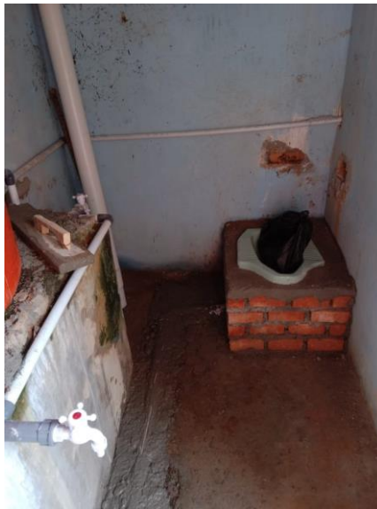
Gambar 3. Kamar Mandi Putra Sebelum Direnovasi
